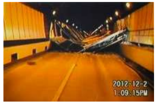
Effondrement du plafond du tunnel Sasago (Japon)
